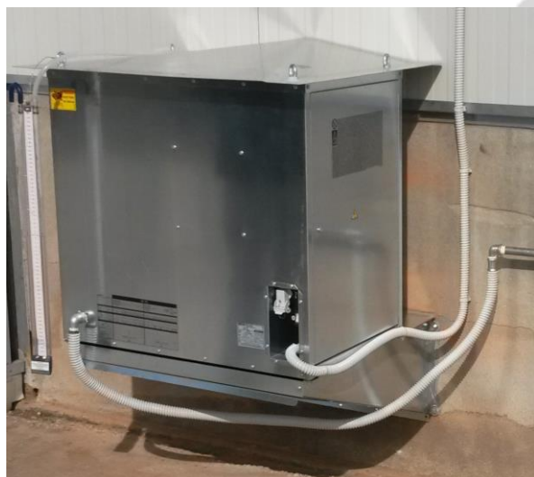
Instalacja na zewnątrz
