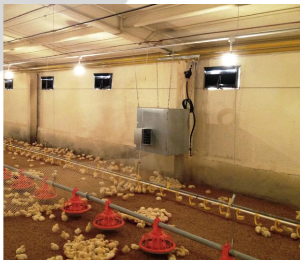
Instalacja na wewnątrz
